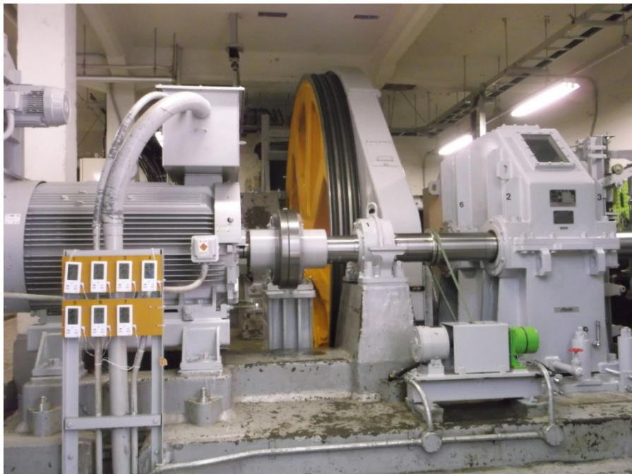
摩耶ケーブル巻上げ設備
